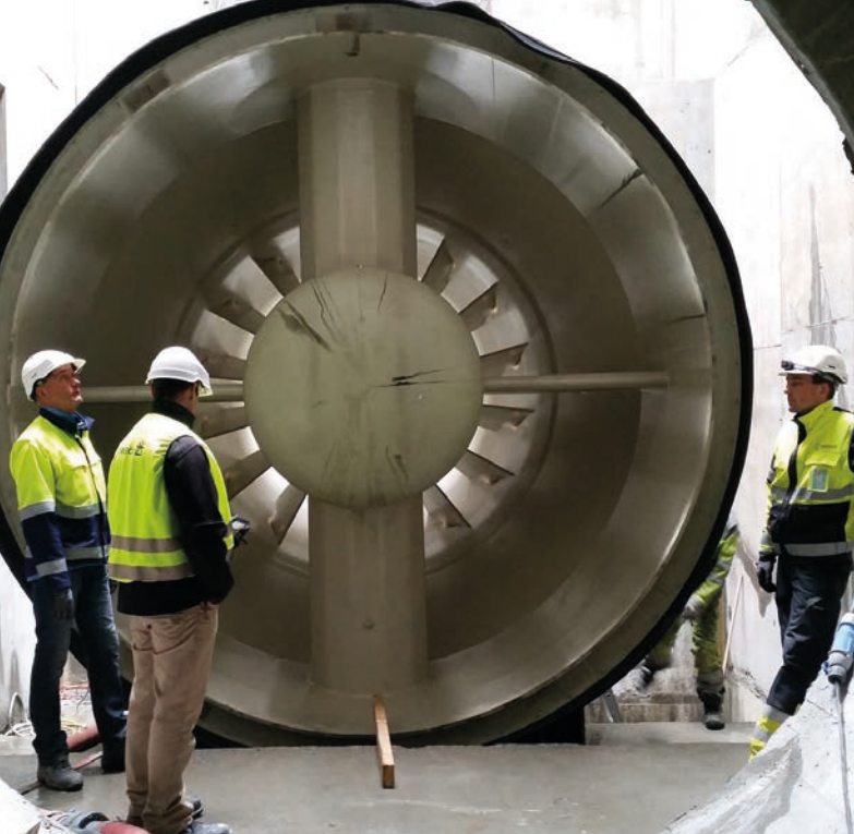
Instalação de pequena turbina Bulbo
