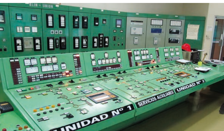
Antigo sistema de controle existente na UHE Carlos Fonseca
